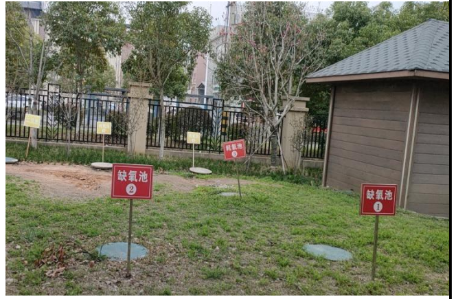
地埋式处理池
