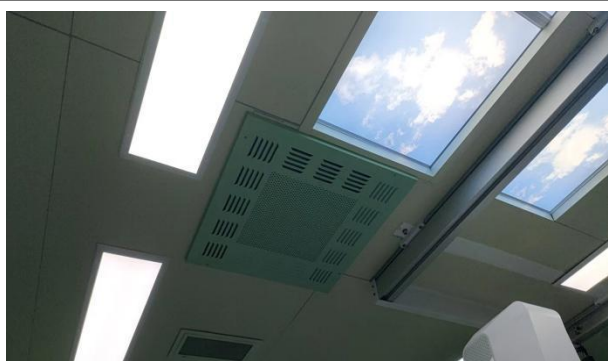
机房通风系统
